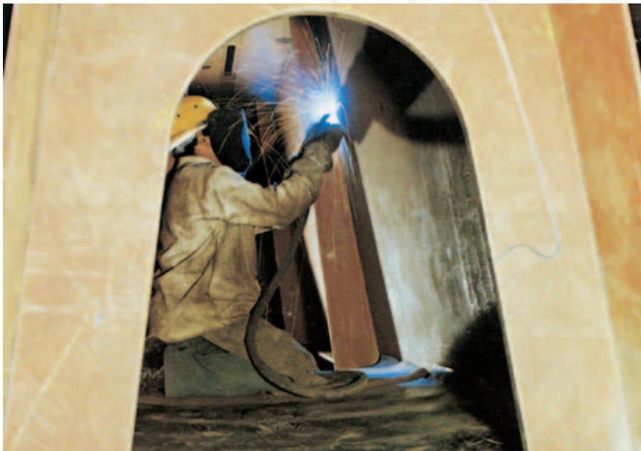
Bild 4-1: Lichtbogenschweißer unter erhöhter elektrischer Gefährdung, durch isolierende Unterlage geschützt
