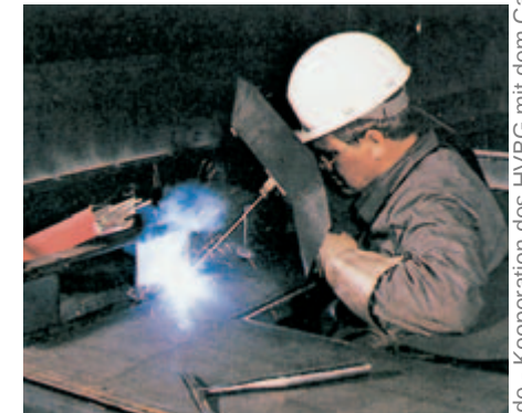
Bild 4-3: Lichtbogenschweißer unter erhöhter elektrischer Gefährdung, durch isolierende Zwischenlage geschützt
